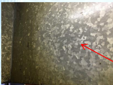
厨房ガス台壁面
